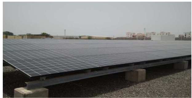
Fig. 1. Rangées des panneaux solaires PV de la centrale solaire
